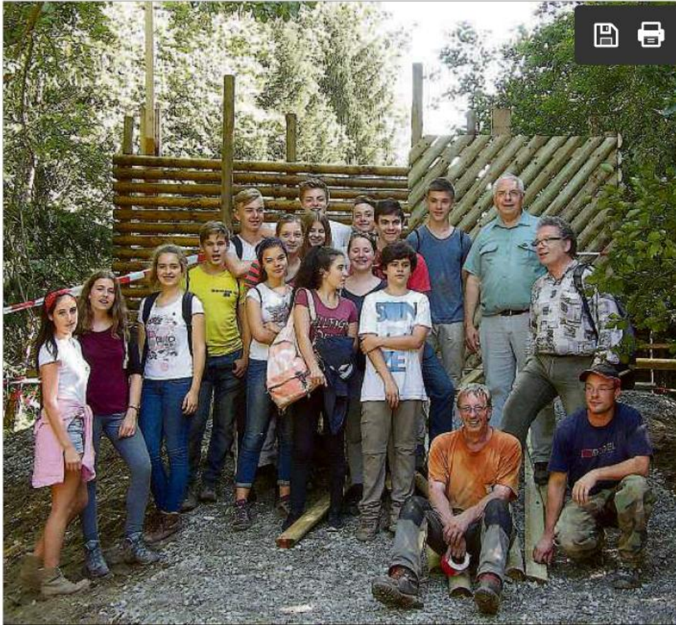
Eine Hütte zur Beobachtung von Rotwild in der Wildruhezone am Troppender Wasen bauten die 16 Heidelberger Schüler/innen mit Hilfe von Erwachsenen und angeleitet vom Bebenhäuser Revierförster Rainer Pohl. Privatbild
