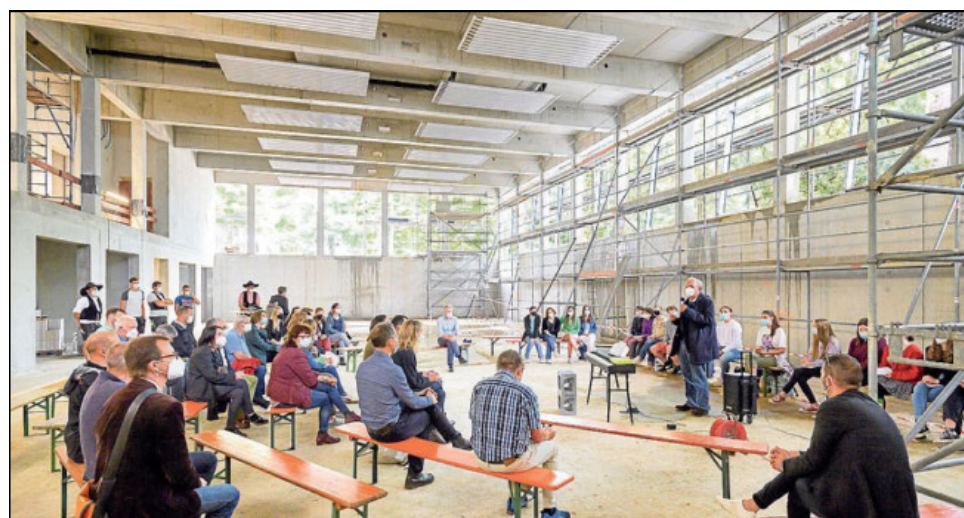
In der künftigen Sporthalle im Neubau neben der Elisabeth-von-Thadden-Schule in Wieblingen wurde das Richtfest gefeiert. Foto: Philipp Rothe
